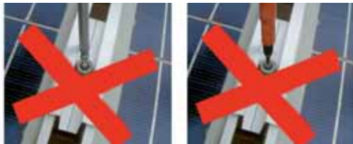
Schraube mit normalen Werkzeugen nicht zu öffnen! Durch die sehr enge Mittelklemme ist auch ein Lösen mittels Zange unmöglich.
